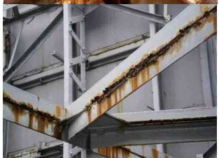
↑内部鉄骨のサビ・腐食。
