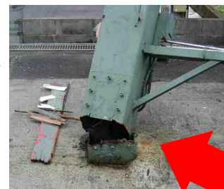
折れた柱の根元。点検口のボルト穴からサビが入り腐食して、鉄骨が破断した。
