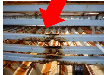
↑目隠しルーバーのサビ・腐食。
