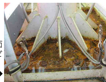
看板の根元がカバーで覆われている場合、表面はきれいでも内部でサビが進行している恐れも。
