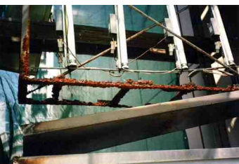
↑看板底部の脱落
