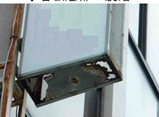
↑看板底部の留め具が壊れるとアクリル板が抜け落ちる原因にも。
