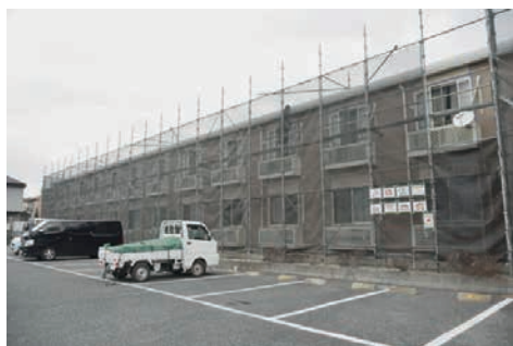
施工不良が見つかったレオパレス21のアパート＝千葉県流山市で13日、松本惇撮影
